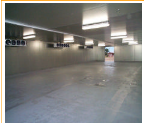
El cuarto frío para exportación de pepino en La Paz (Agro Duncris) permitió una expansión en producción de 70 a 130 hectáreas.
