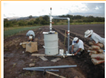
Instalación filtro diseñado por CDA.
