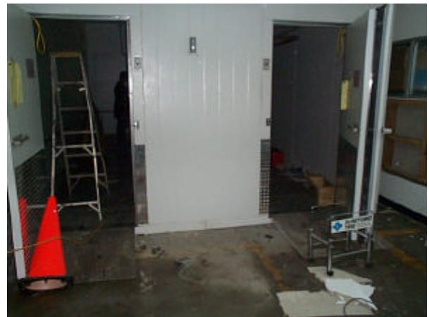
Instalación de cuarto de congelamiento en un procesador de frutas congelados
