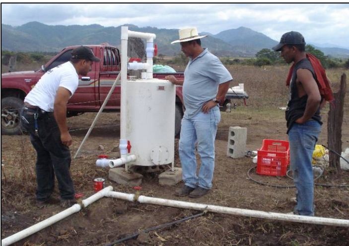
Equipo de riego por goteo
