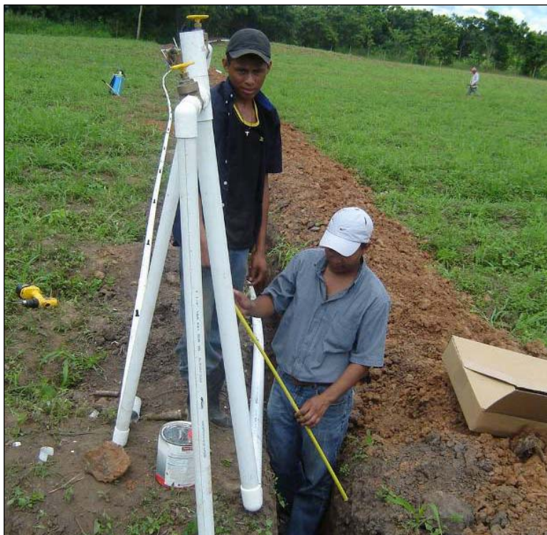
Instalación de riego, CARITAS, Juticalpa
