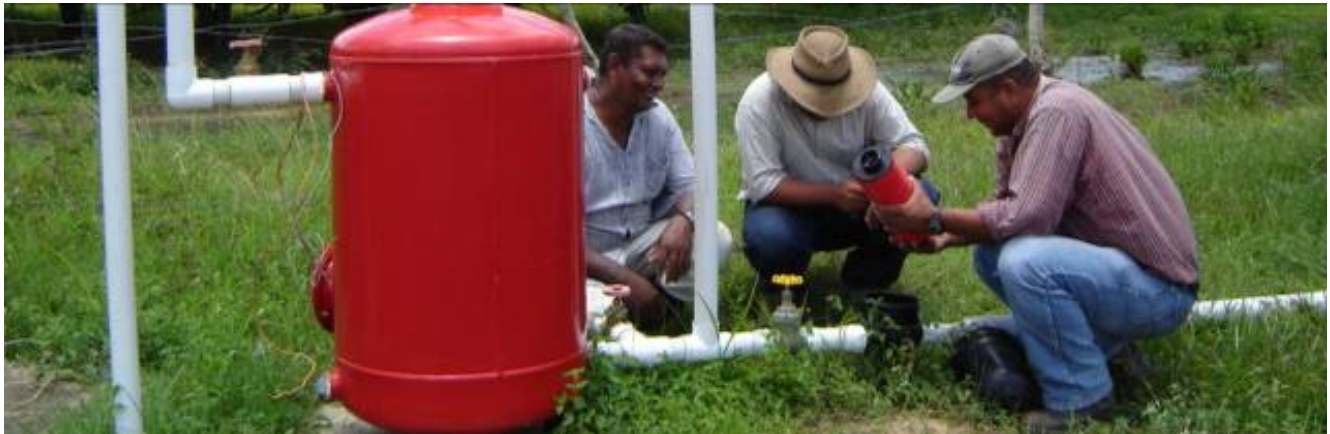
Limpieza de Filtro de Riego por Goteo
