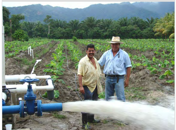
Prueba de pozo y bomba de agua, EAC 25 de Marzo, Choloma, Cortés
